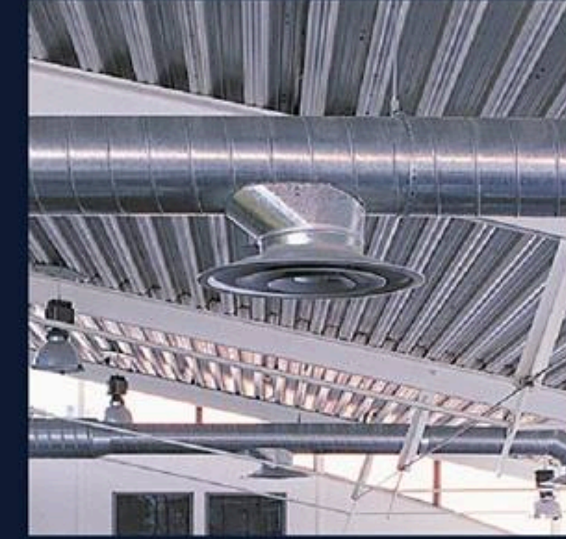
مقاولات تكييف HVAC CONTRACTING
